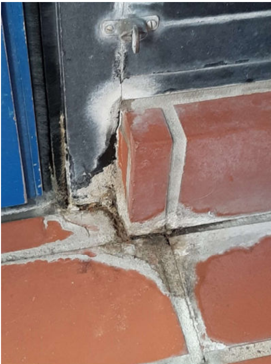
„Weiß-Rost“ und Kalksteinbildung infolge Wasseraufnahme durch Risse
