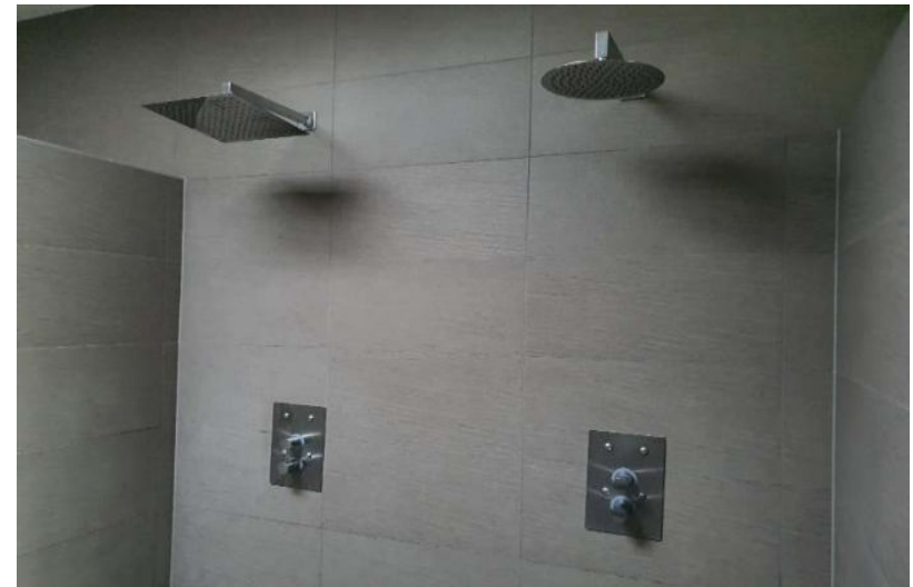
Rohrleitung in unsanierten Bereichen als Stichleitungen unzulässig → Gefahr der Legionellenbildung
