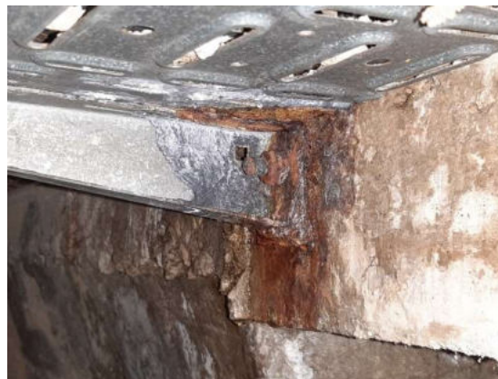
abgerostete Traversen der Kabelbühnen
